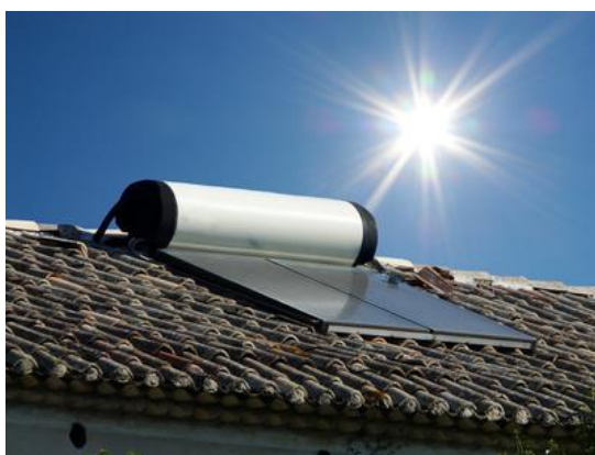
Figure 38 - Chauffe-eau solaire collectif
