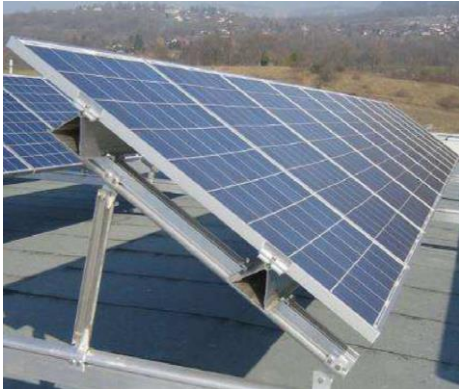
Figure 28 - Panneaux solaires sur châssis
