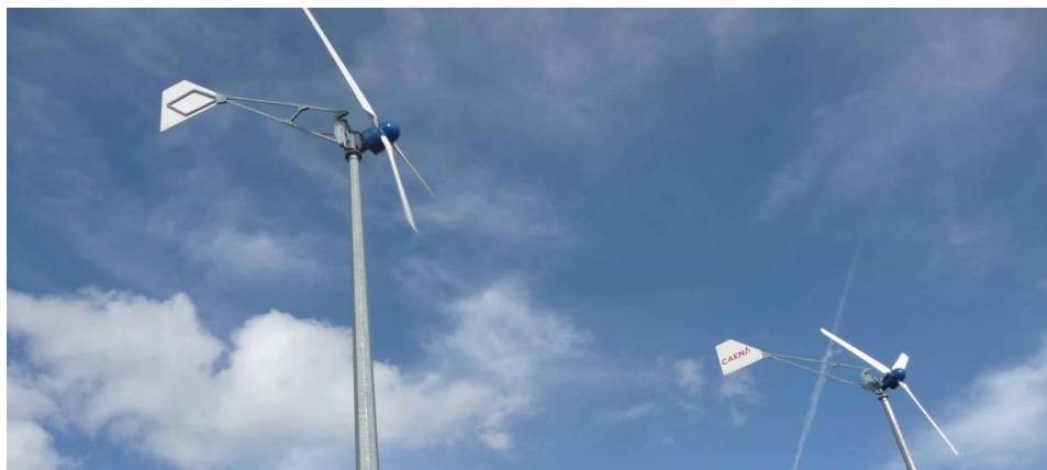
Figure 21 - Eoliennes à axe horizontal de la Communauté d'Agglomération de Caen la Mer
