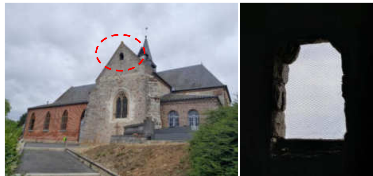
Figure 27. Accès principal aux combles de l'église Saint-Rémi de Bois-lès-Pargny obstruée par un grillage vu de l'extérieur (à gauche, entourée en rouge) et de l'intérieur (à droite) - T. Kestel, Ecosphère.
