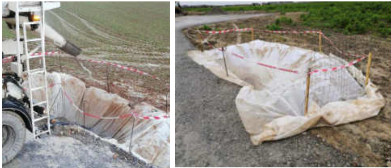
Vérification des bonnes pratiques en phase chantier pour le coulage des machines
