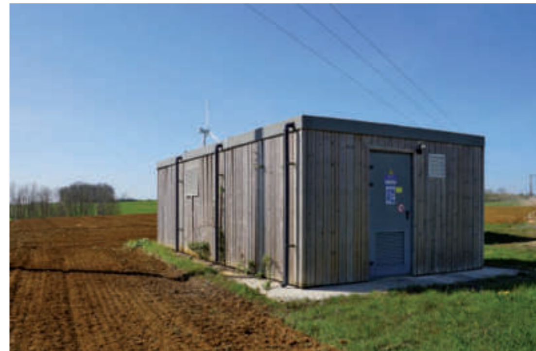
Exemple de poste de livraison habillé d'un bardage bois (parc éolien de Tarzy / Ardennes).
