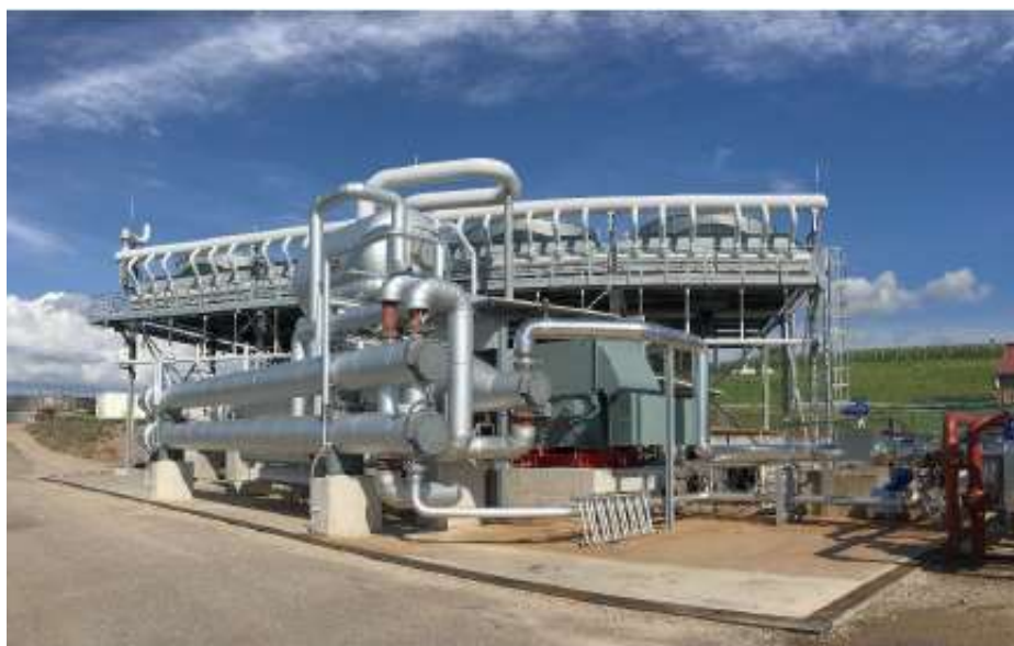
Figure 4 : Photo de la centrale géothermique de Sultz-sous-Forêts
