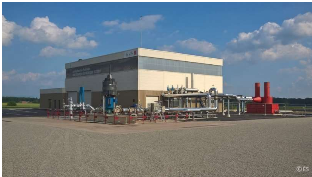
Figure 3 : Photo de la centrale géothermique de Rittershoffen
