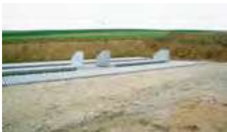
Photo 45 : Fosse recouverte de caillebotis et dalles logettes (crédit photo : Idele)
