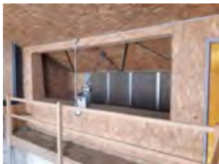
Photo 39 : Trappe de ventilation (crédit photo : Segrafo)
