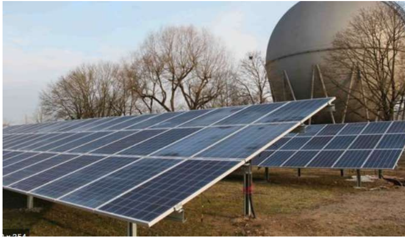
Figure 52 : Illustration d'une table photovoltaïque. Source : OBTON
