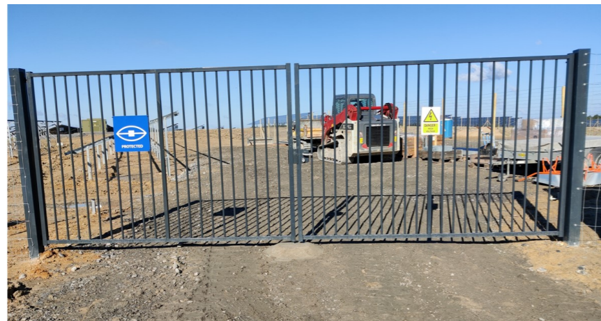
Figure 16: Exemple d'un portail de la centrale photovoltaïque
