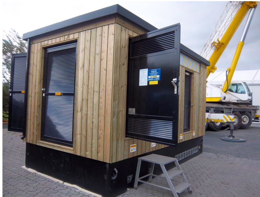
Photographie 2: Exemple d'un poste de conversion avec habillage bois
