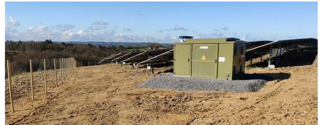
Photographie 1 : Exemple d'un poste de conversion
