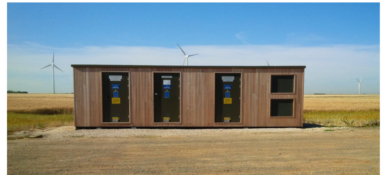
Figure 5 : exemple d'un poste de livraison
