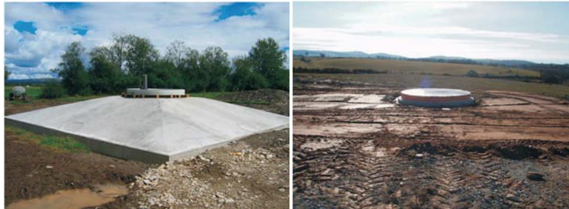
Figure 8 : Exemple de massif béton terminé (à gauche), état final après remblaiement (à droite)
