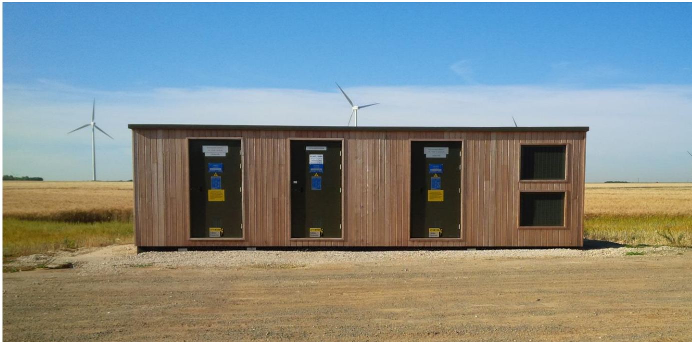
Photo 8 : Exemple d'un poste de livraison
