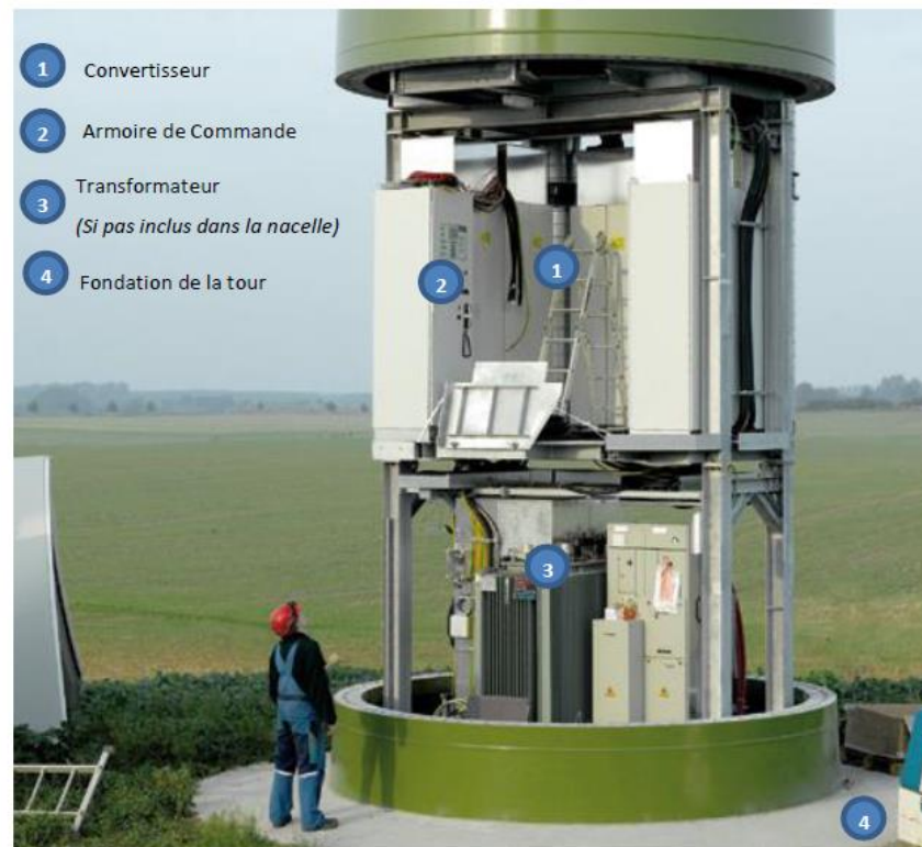
Illustration 1 : Transformateur inséré dans le mât (Enercon)
