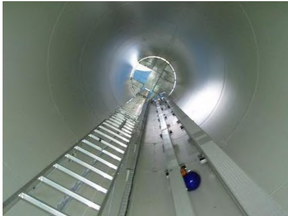
Photo 5 : Intérieur d'un mât équipé
