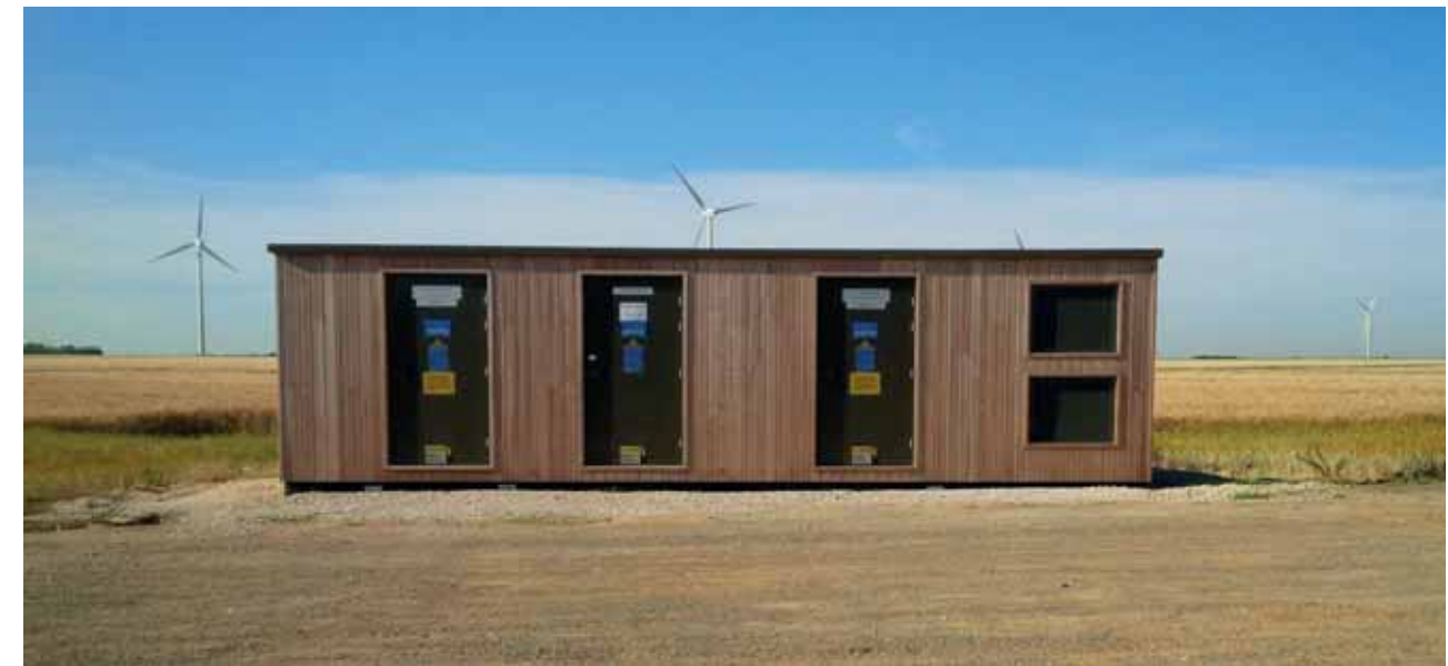
Photo 5 : Exemple d'un poste de livraison
