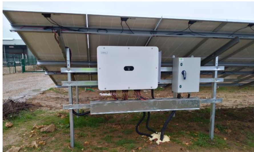
Figure 3 Onduleurs photovoltaïques fixés à la structure porteuse des modules (source : SOG SOLAR)
