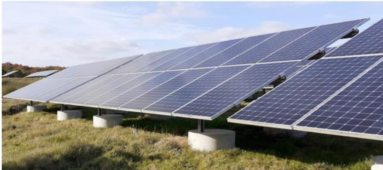
Figure 2 Photo structure photovoltaïque sur plot béton (source : Sydela Energie 44)
