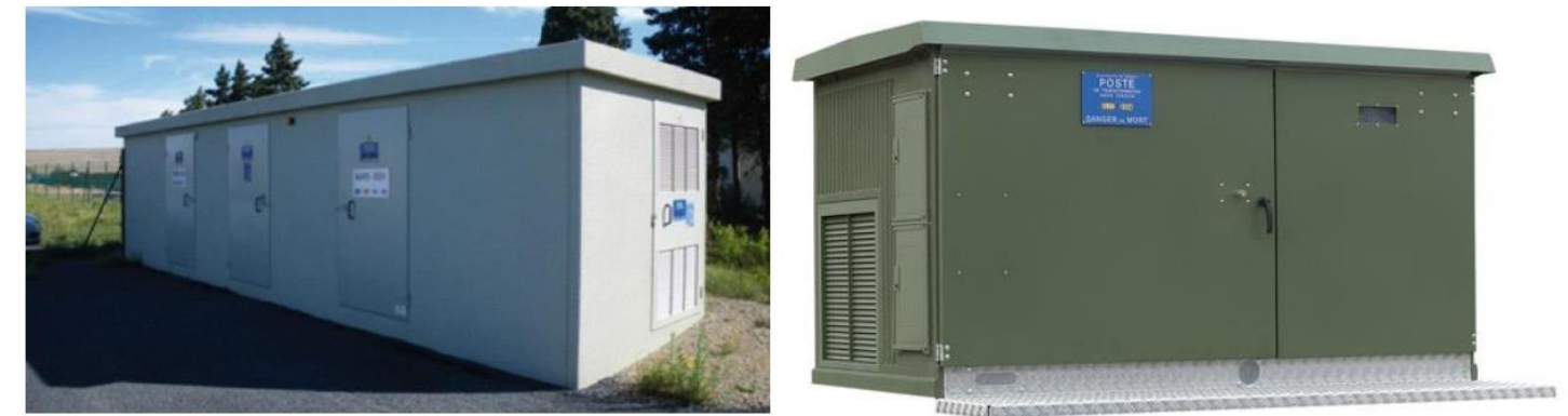
Figure 4 Poste de Livraison à gauche, Poste de Transformation à droite (source : Encis Environnement et Groupe Cahors)
