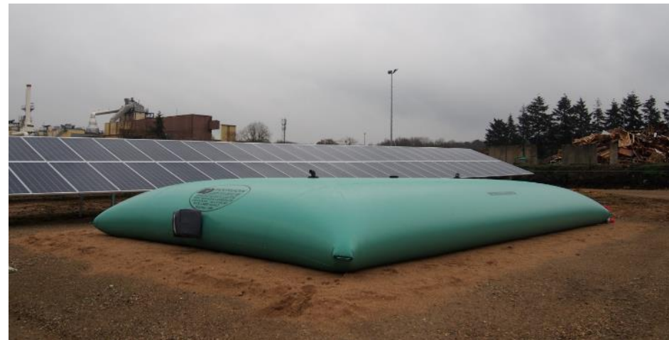
Figure 6 Réserve incendie souple (Source : SOG SOLAR)
