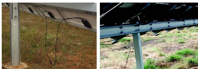
Photo 10 : A gauche, un exemple de câble électrique qui pend et à droite, un exemple de fixation de câbles électrique avec des serre-câbles (Source : IDELE)
