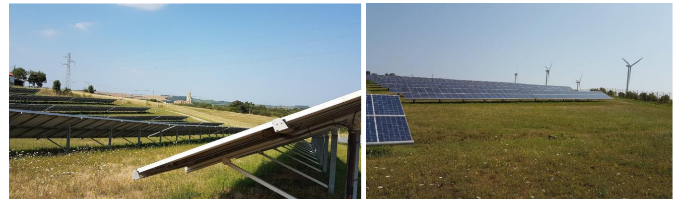
Photo 2 : Exemple de panneaux (Source : BORALEX)
