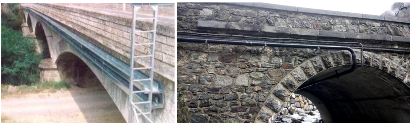
Figure 102 : Exemple de passage de câble par encorbellement A gauche : Installation de goulotte pour passage de câbles (Source : Nogues) A droite : Passage du réseau électrique dans des tubes acier (Source : 2cordesacordes)
