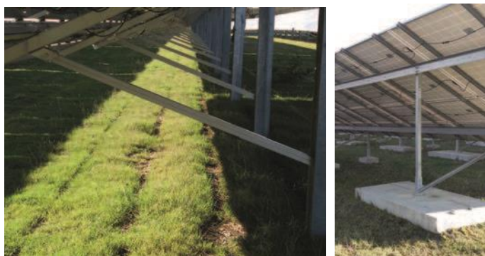
Photo 9 : Exemple de fixations au sol (à gauche, des tables fixes sur mono-pieux battus et à droite, des tables fixes bi-pieux sur dalles de béton) (IDELE)
