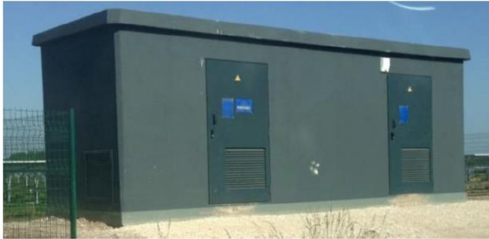
Photo 5 : Exemple d'un poste de livraison (BORALEX)
