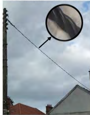
Réseau fils isolés aérien BT
