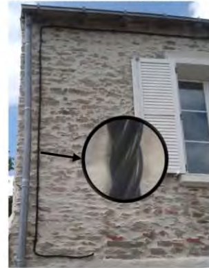
Réseau fils isolés façade BT
