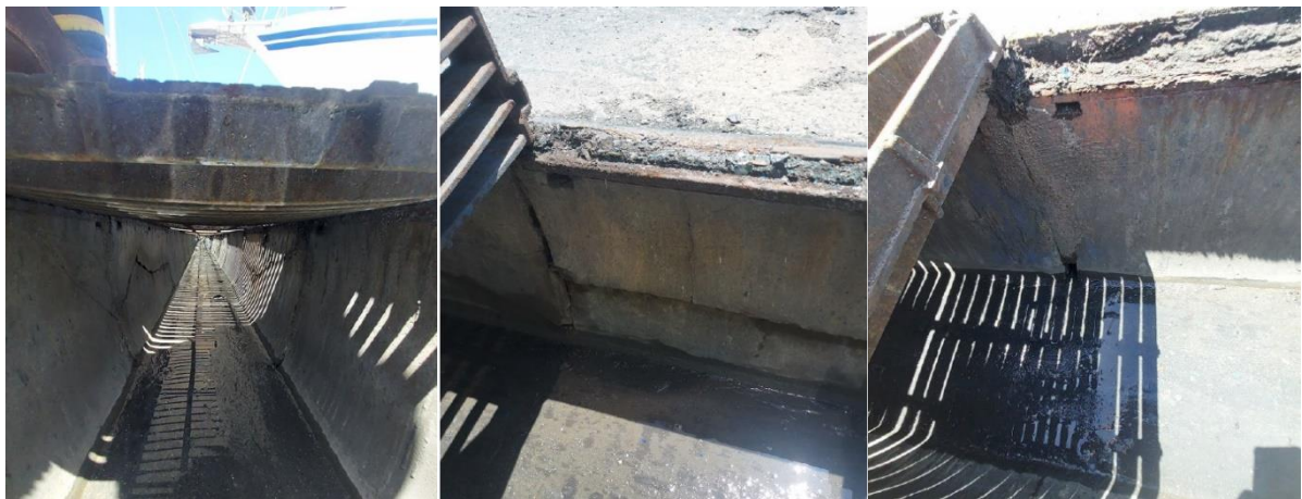
Figure 21 : Photos des désordres relevés sur les caniveaux (Cerretti, juin 2024)
