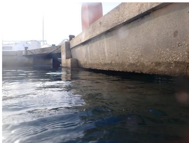
Figure 107 : Prise de vue d'un ponton (étages supra et médiolittoral supérieur très limités)
