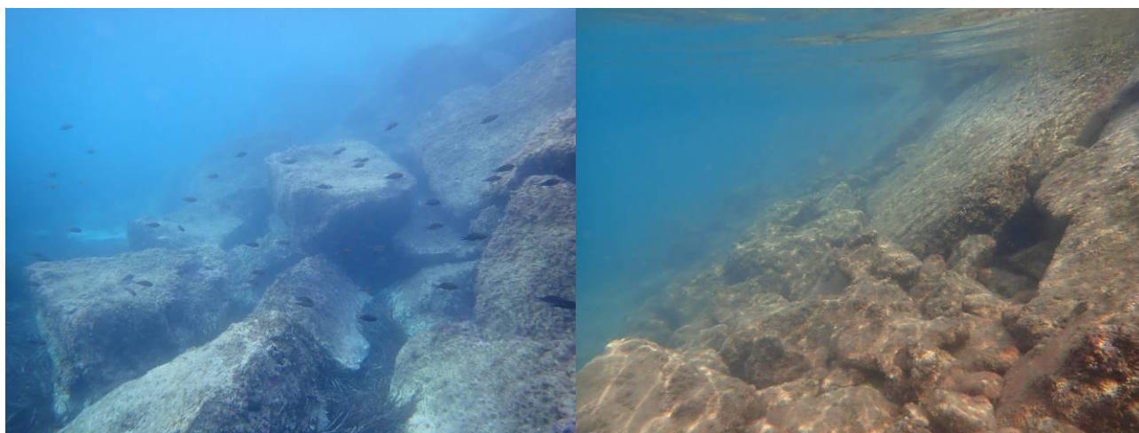
Figure 110 : Prises de vue des enrochements des digues à l'extérieur du port (à gauche) et à l'intérieur (à droite)
