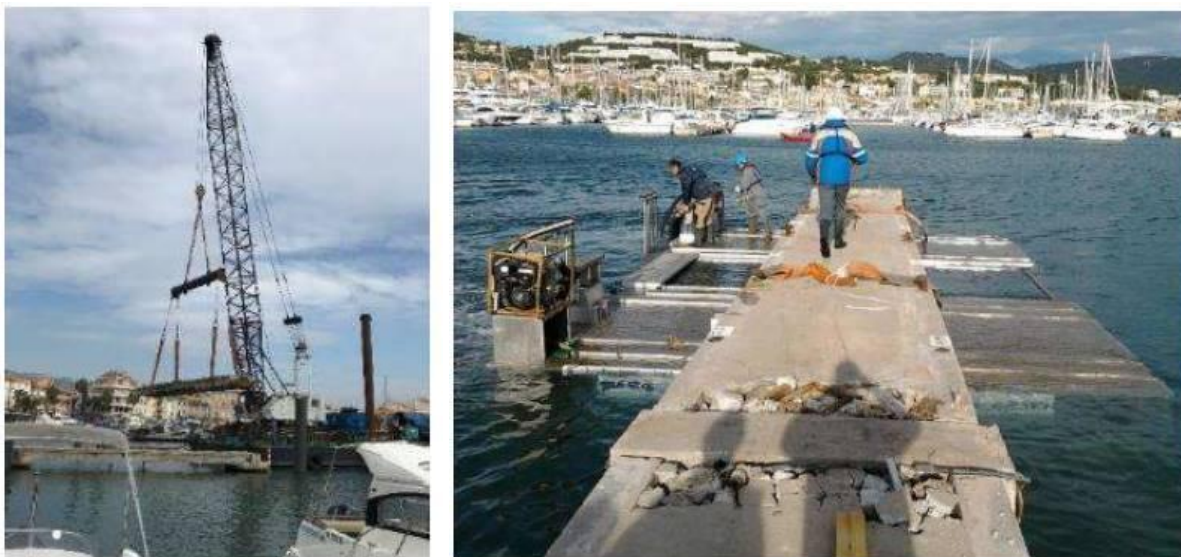
Figure 25 : Levage d'une travée béton par grue sur barge (à gauche), dépose avec un caisson – panne C, 2013 (à droite)
