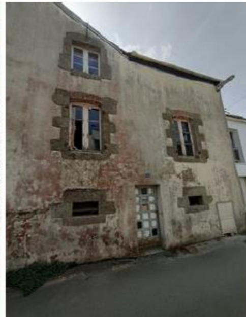
Logements vacants en apparence dégradés
