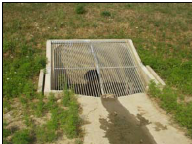
Figure 19 : Grille de protection sur ouvrage de sortie
