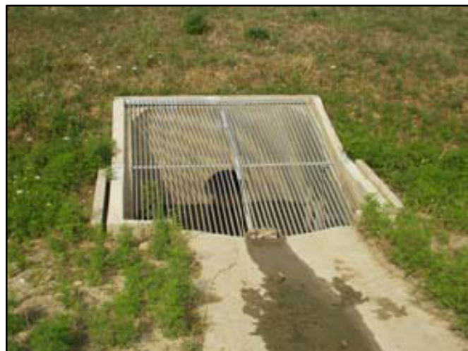
Figure 19 : Grille de protection sur ouvrage de sortie
