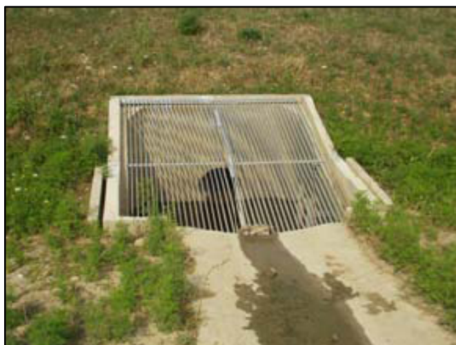
Figure 19 : Grille de protection sur ouvrage de sortie
