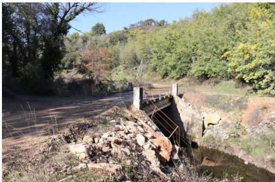
Pont sur le Riou de l'Argentière, sans garde corps et culées affouillées
