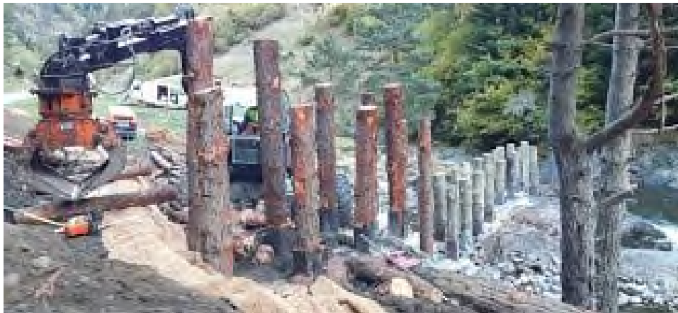
Photo 1 : Exemples de piège à embâcles
