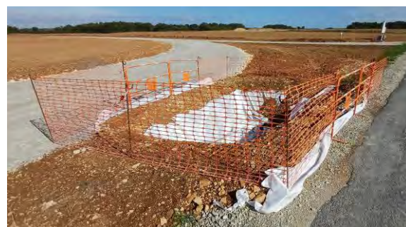
Photo 17 : Cuve de rinçage (Jpee)
