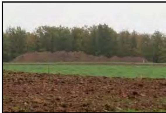
Figure 120 : Terre végétale stockée sur un chantier de centrale photovoltaïque (Source : Abies, suivi de chantier)
