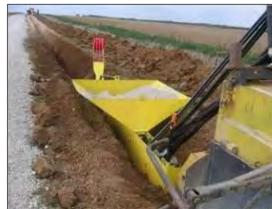
Photo 9 : Engin utilisé pour le creusement de la tranchée et la pose des câbles
