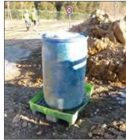
Figure 117 : Stockage d'hydrocarbures dans un bidon étanche sur bac de rétention (Source : Abies, suivi de chantier)
