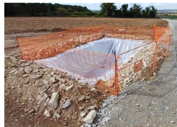
Photo 18 : Cuve de rinçage (Jpee)
