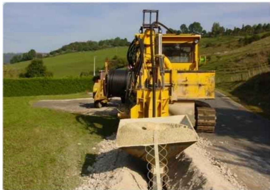
Photo 103 : La pose d'un câble souterrain depuis le poste de livraison jusqu'au réseau électrique public
