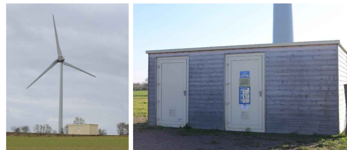
Photo 102 : Exemples de poste de livraison électrique
