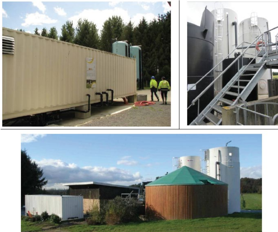
Figure 9 : Station de traitement des lixiviats
