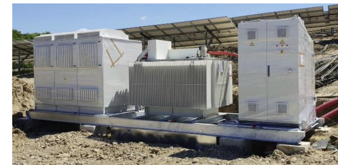
Figure 28 : Poste de transformation
