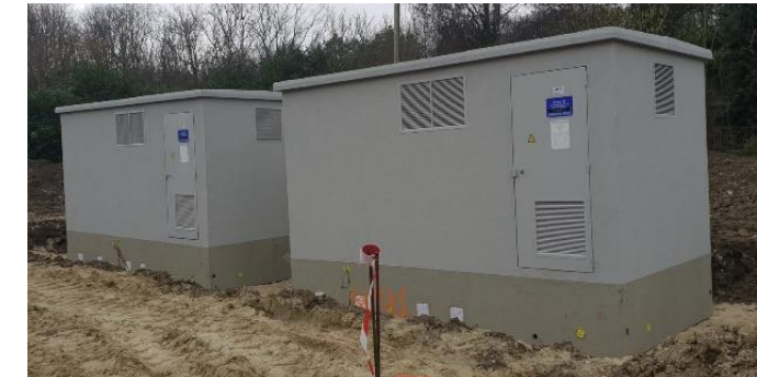
Figure 27 : Poste de livraison
