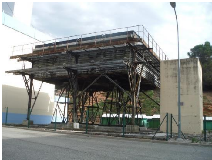
Figure 16. Photographie de l'aéroréfrigérant
