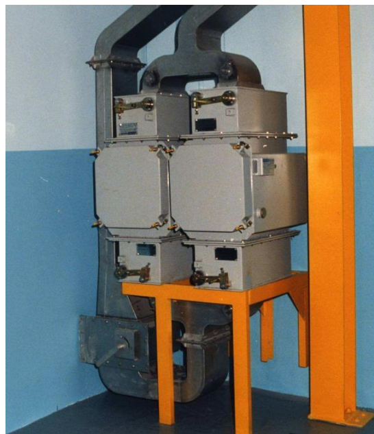
Exemple de filtres THE montés en parallèle pour assurer le maintien de la filtration lors du changement de filtre
