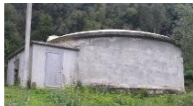
réservoir route de Chisa
