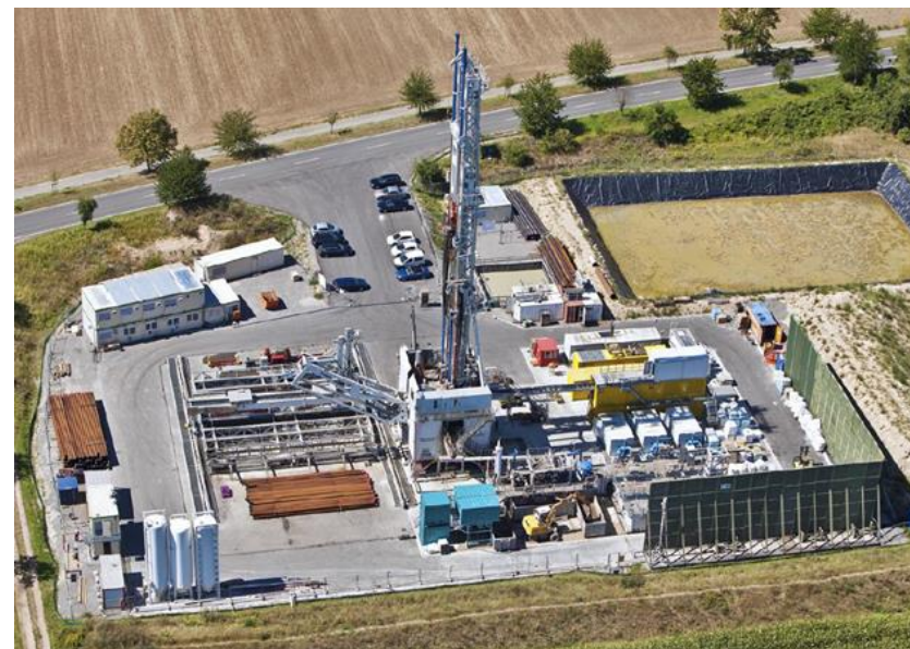
Exemple de forage et d'équipements auxiliaires similaires à ceux du projet LPX
