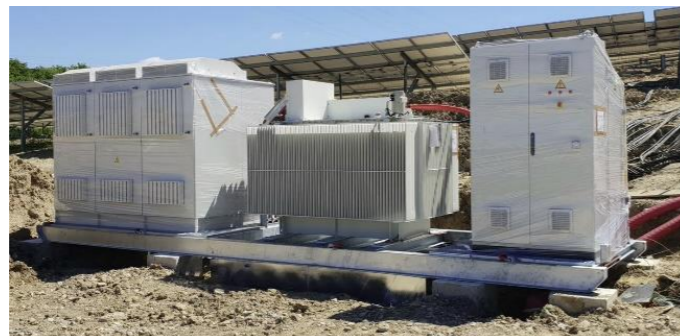
Figure 47 : Poste de transformation
