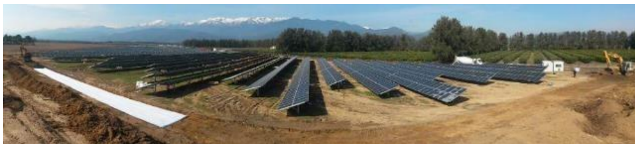
Figure 77 : Montage des structures sur pieux battus et des panneaux sur le chantier du projet Mortella, à Ghisonaccia (source : Akuo)
