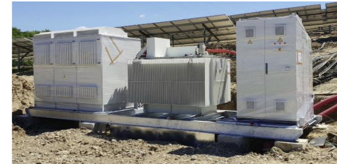
Figure 63 : Poste de transformation
