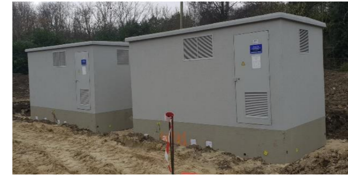
Figure 62 : Poste de livraison
