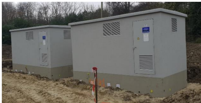
Figure 96 : Poste de livraison
