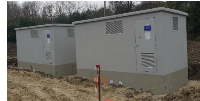
Figure 78 : Poste de livraison
