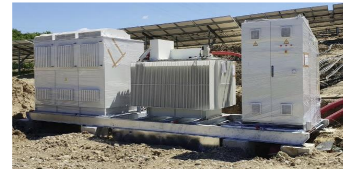
Figure 79 : Poste de transformation
