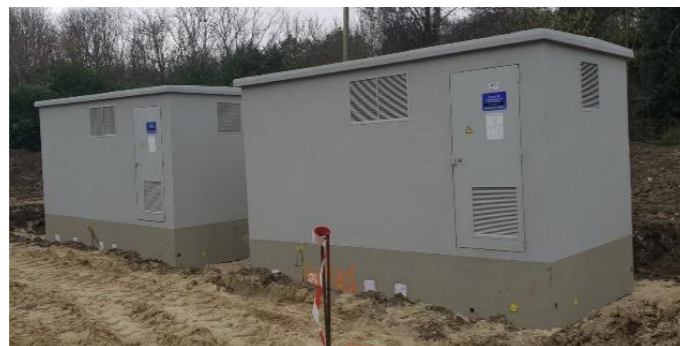
Figure 46 : Poste de livraison
