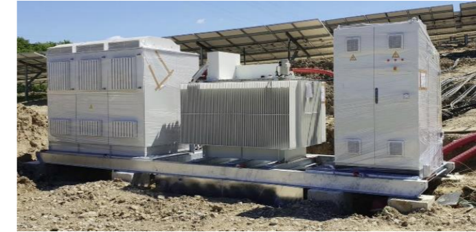
Figure 97 : Poste de transformation
