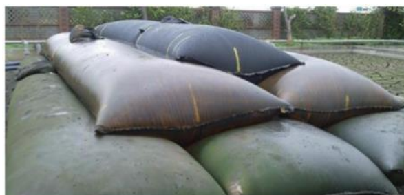
Tubes filtrants de déshydratation des boues
