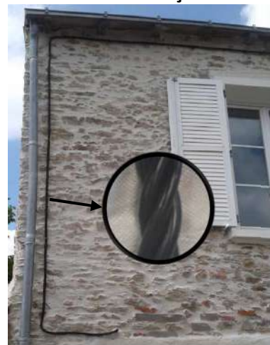
Réseau fils isolés façade BT
