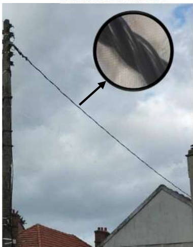
Réseau fils isolés aérien BT
