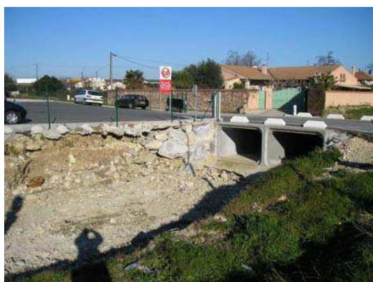
Affouillements sur la Pondre à Milhaud (source : SAFEGE, 2006).
