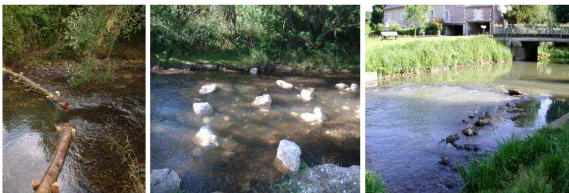
Exemple de travaux réalisés sur la Brenne (37) – Photos : Fabien Languille : déflecteurs en bois, dispersion de blocs sur un radier, création d'un mini-seuil
