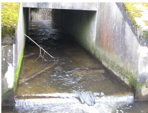
Illustration de barrettes offset fixées sur un radier de pont du Chandon (61) à St Denis sur Sarthon – Photo : PNRNM
