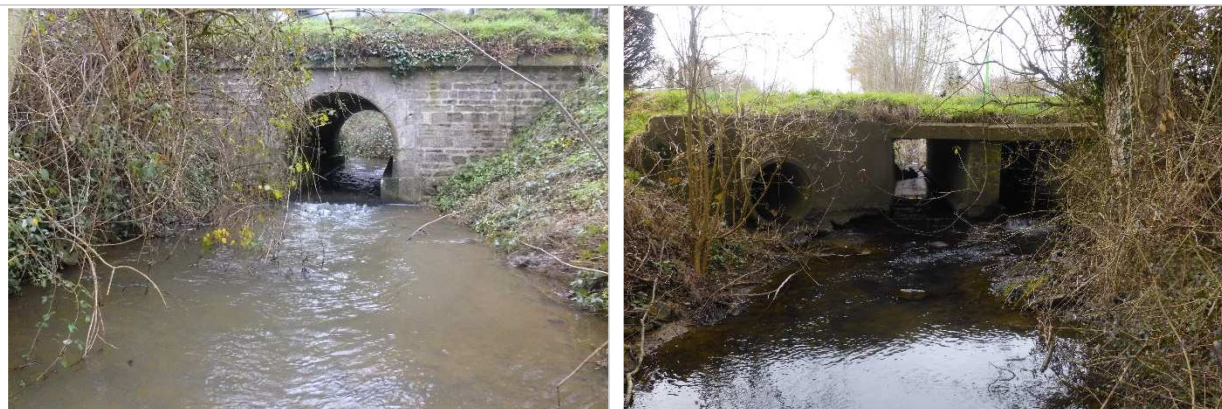
Exemple d'un radier de pont sur le Moulin Chahains (aval D1) et sur le Gesnes (« la Brûlette » à Arçonnay) concernés par un projet de recharge en aval
