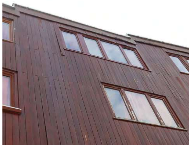
En bas, une menuiserie d'origine e bois, en haut une menuiserie remplacée, façade nord-est © archipat, janvier 2022
