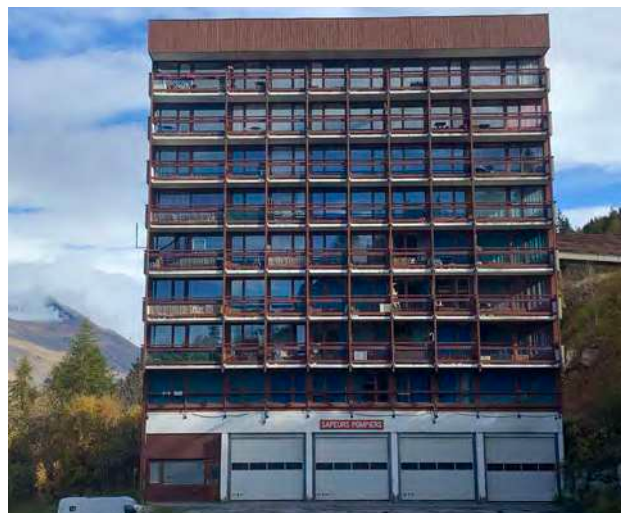
Brises vues sur certains balcons rompant l'uniformité des façades © archipat, octobre 2021
