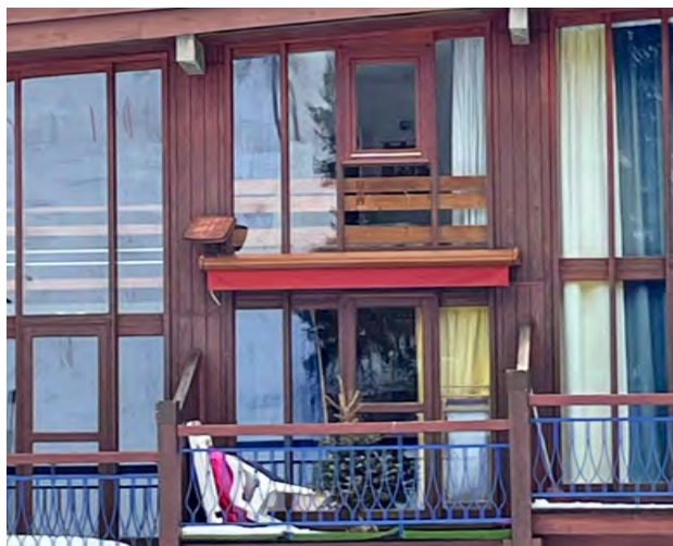
Les façades modifiées par de nouveaux ouvrants, un store banne et des garde-corps rapportés © archipat, février 2022
