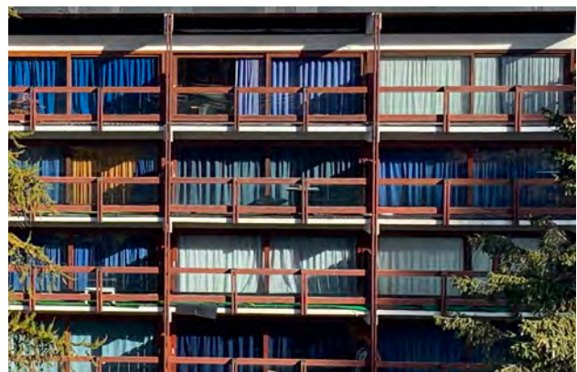
Menuiseries et boiseries des balcons © archipat, octobre 2021
