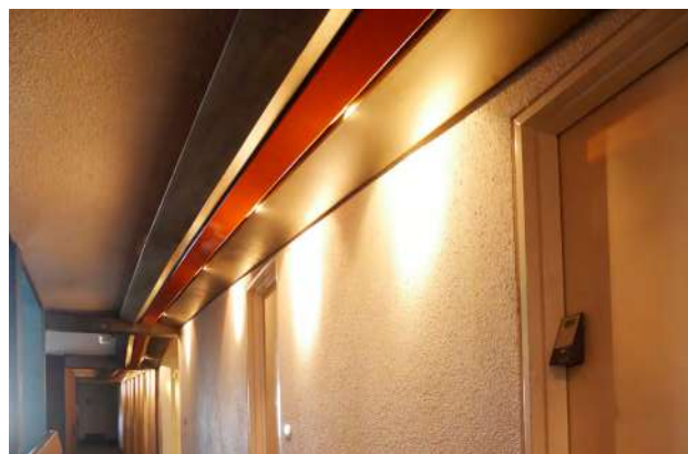
Luminaires des rampes des Belles Challes © archipat, janvier 2022
