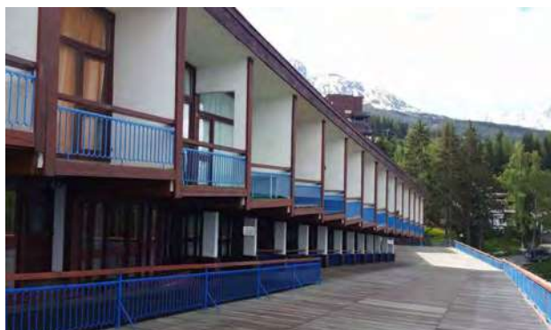
Toiture terrasse en lames de mélèzes et duplex du Pierra Menta © ASCAUDIT, 2016
