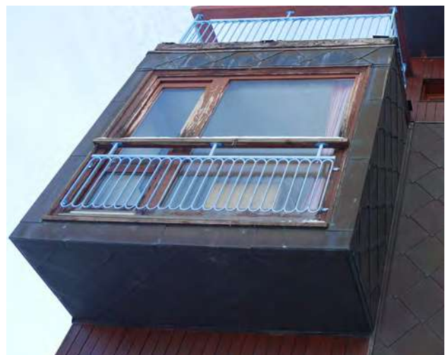
Des menuiseries bois d'origine altérées © archipat, janvier 2022
