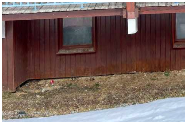
Des planches de bardages abîmées en pieds d'immeuble © archipat, janvier 2022
