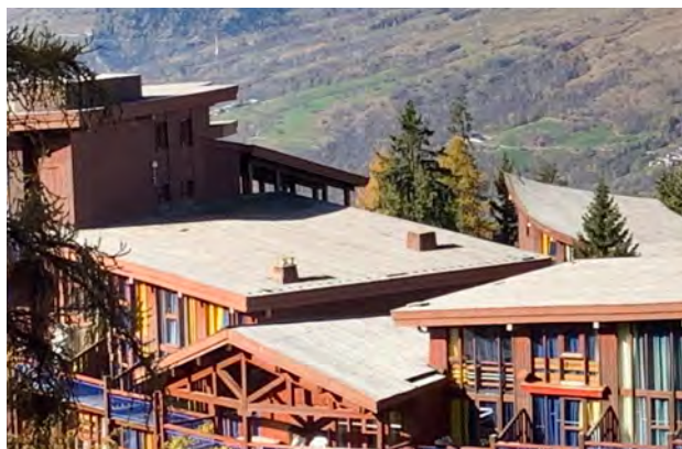
Les toitures altérées © archipat, octobre 2021
