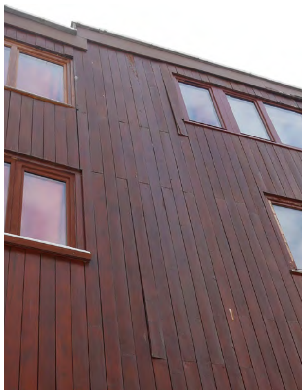
Planches de bardage altérées © archipat, janvier 2022
