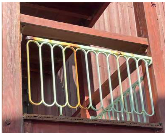
Lasure abîmée, garde-corps rouillé et altéré, teinte verte délavée © archipat, janvier 2022
