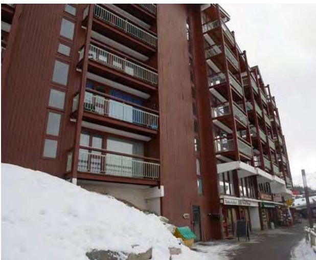
Soubassement et consoles en béton, bardages et structures bois des Tournavelles © archipat, janvier 2022
