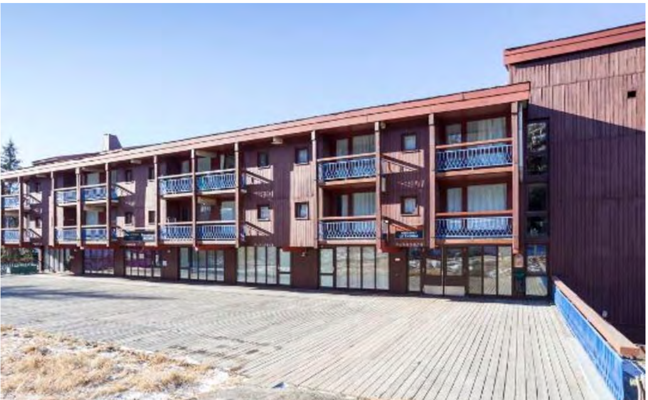
Résidence Thuria : menuiseries remplacées en rez-de-chaussée, garde-corps et rideaux trop clairs
