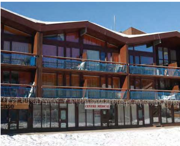
Menuiseries bois, double vitrage, rideaux intérieurs et garde-corps des Arandelières © archipat, janvier 2022
