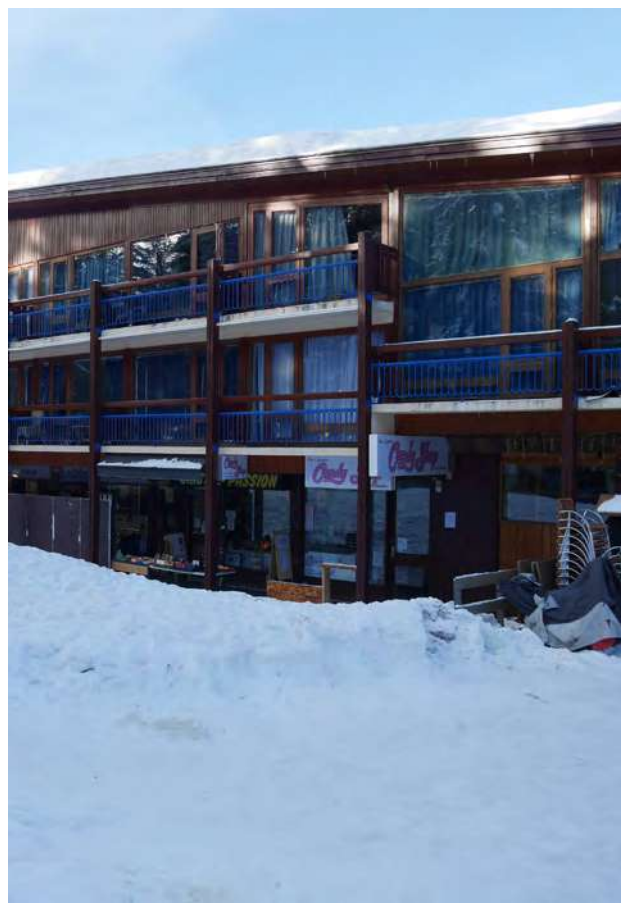
Les rez-de-chaussée commerciaux encombrés de mobilier, enseignes, pré-enseignes qui alourdissent les façades © archipat, janvier 2022
