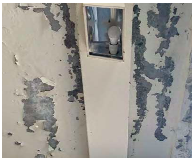
Peinture des bétons éclatées en sous-face des balcons formant la galerie commerciale du front de neige © archipat, janvier 2022
