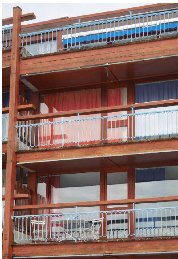
Planchers des balcons abîmés et défauts d'étanchéité du dispositif d'évacuation des eaux pluviales des balcons © archipat, janvier 2022
