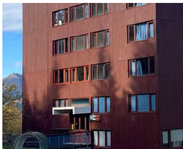
Deux ensembles de menuiseries remplacés au premier étage (teinte différente) © archipat, octobre 2021
