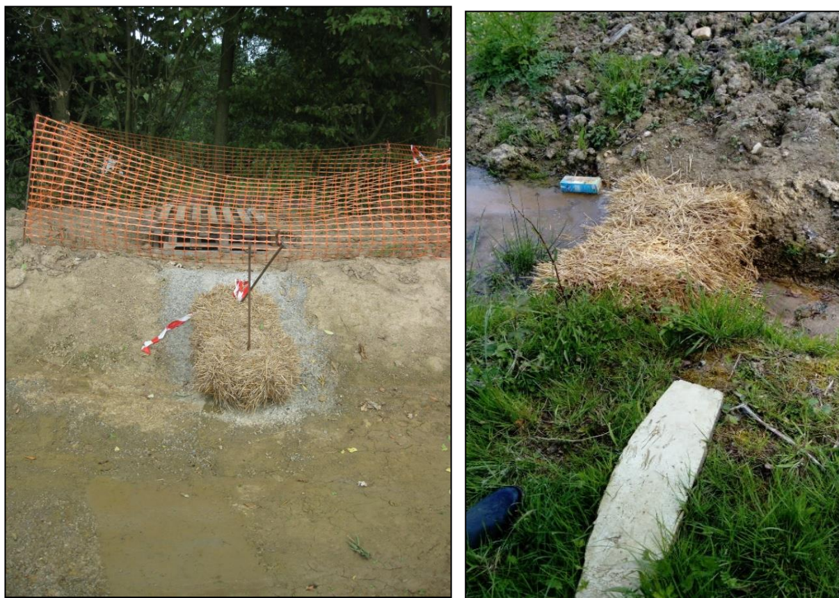
Figure 40 : Emplacements du filtre à particules fines (botte de paille) pendant la phase des travaux au niveau du bassin d'orage
